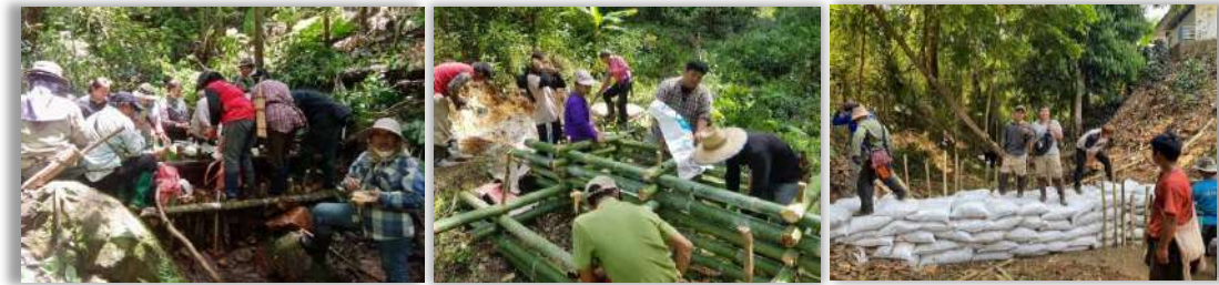
ภาพแสดงการสร้างฝายชะลอน้ำในแต่ละหมู่บ้าน
