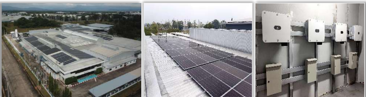
ภาพแสดงโครงการขยายการติดตั้งแผงโซล่า (Solar Roof)
